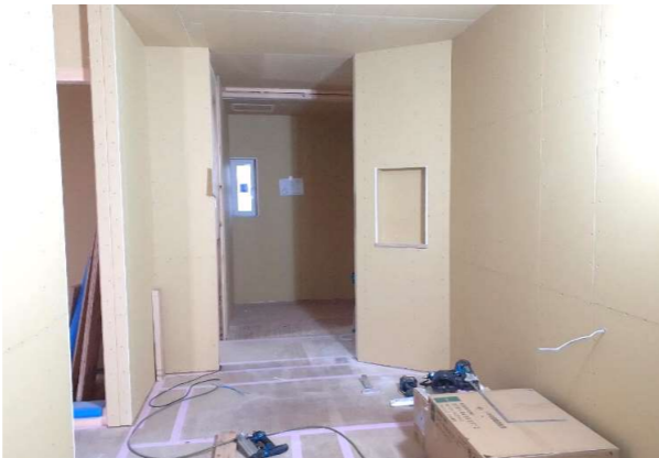
石膏ボードが貼られました。これから内装建具や造作収納の取り付けを行っていきます。
